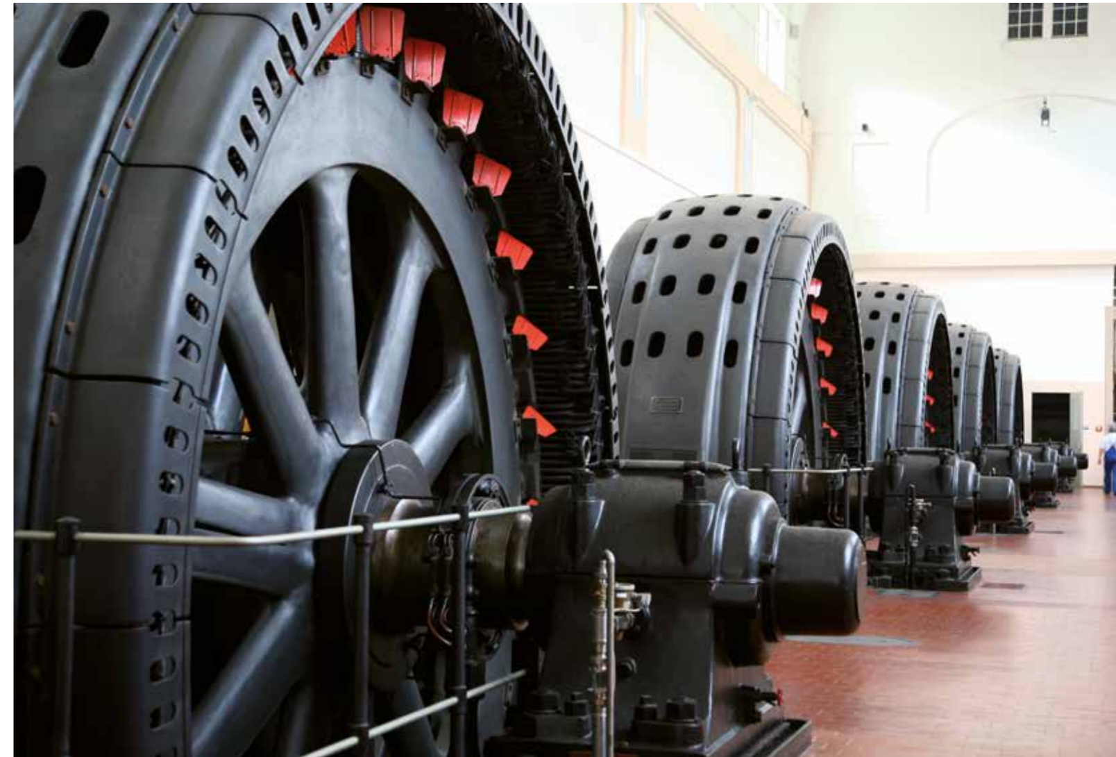
Alter Teil des Maschinensaals in Wyhlen mit Generatoren der Francis- Maschinengruppen
